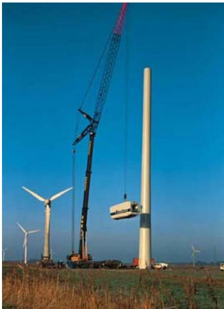
Figura 2.5 – Torre Tubular [Rui M. G. Castro].
