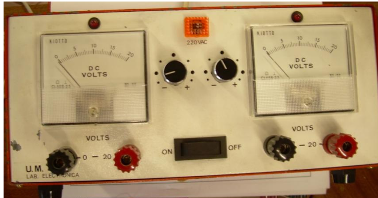
Figura 4.1 – Fonte de tensão usada para alimentar o circuito de controlo
